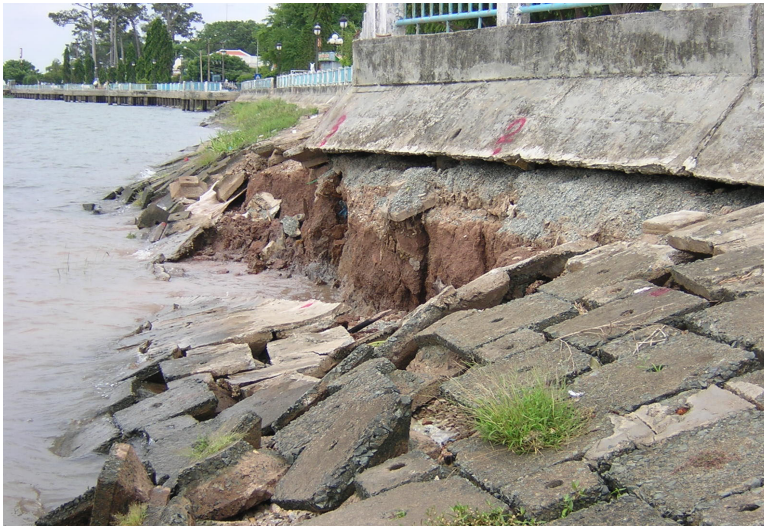
Hình 4: Gạch tự chèn sạt ra phía sông ở phân đoạn 6, kè phường 1, TP. Vĩnh Long ngày 22/06/2005
